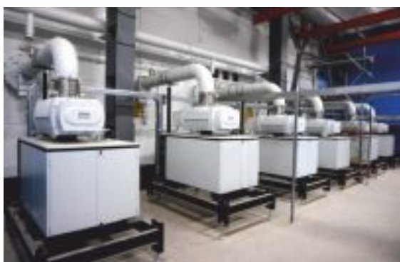
Вакуумная установка электронно-лучевой сварки
